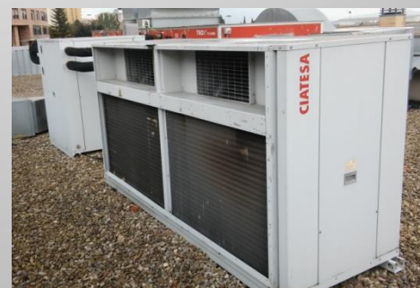
Bomba de calor
